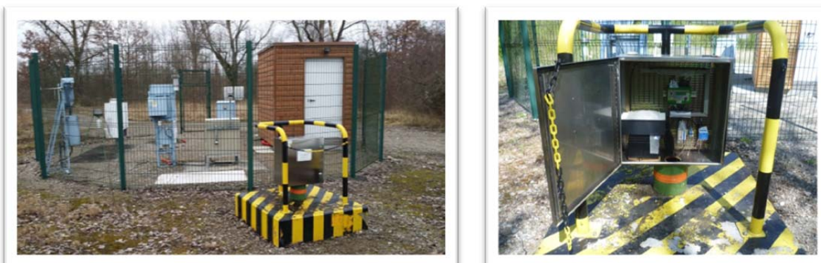
Boîtier situé devant une station météo (propriétaire CNPE de Fessenheim) équipé pour la télétransmission et la gestion de l'humidité
