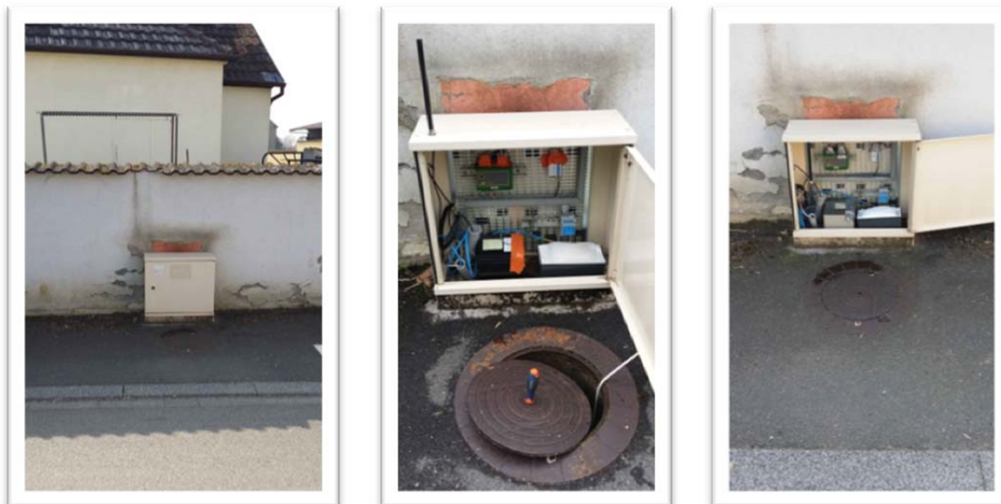
Boîtier équipé d'une antenne GSM à gain pour faciliter la télétransmission
