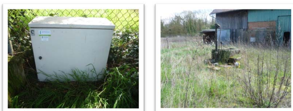
Boîtier contenant la centrale et puits d'accès à la nappe dans la propriété
