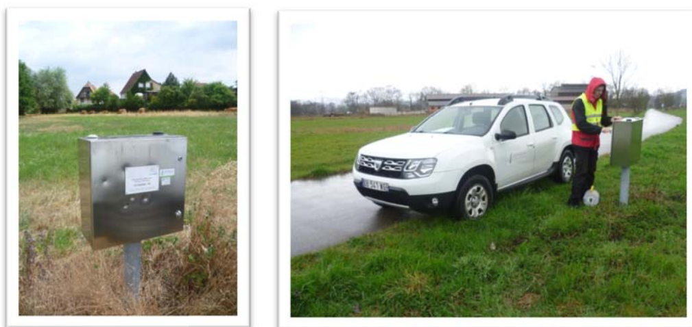
Boîtier situé à Altorf en bordure de route
